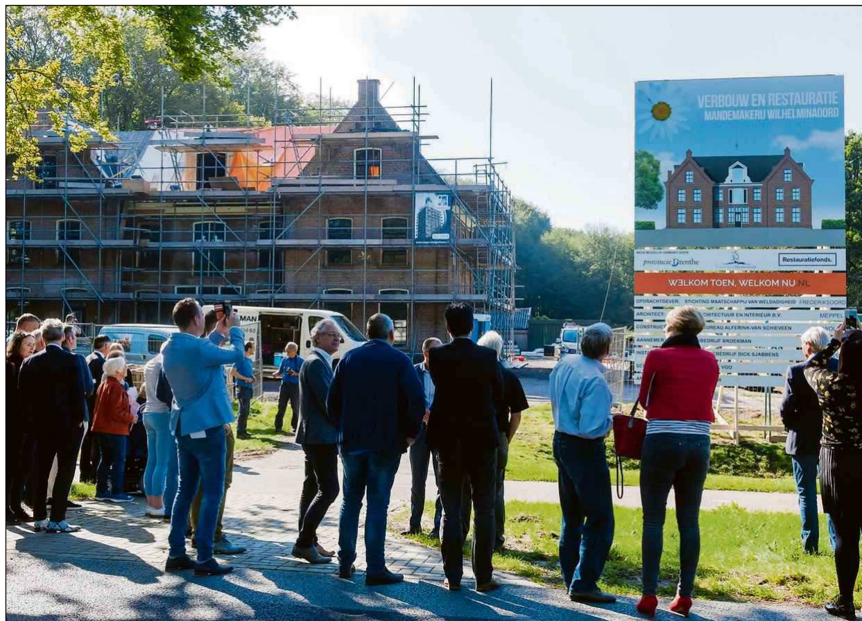
Gedeputeerde Cees Bijl heeft bij de Mandenmakerij die een ingrijpende renovatie wacht, het bouwboard onthuld.
